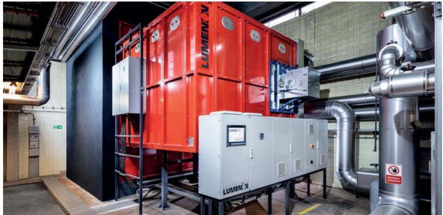
In eine Heizzentrale eines großen Wohnkomplexes in Berlin integrierte Speicheranlage von Lumenion
