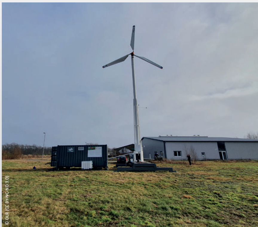
Windthermische Prototypanlage des DLR am Teststandort in Celle.
